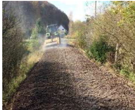
Bild 4: Kosteneinsparung durch Fräsen und Brechen des Bahnschotters auf eine Korngröße analog 0/32 -0/45 + planieren und verdichten (Versuchsstrecke)
